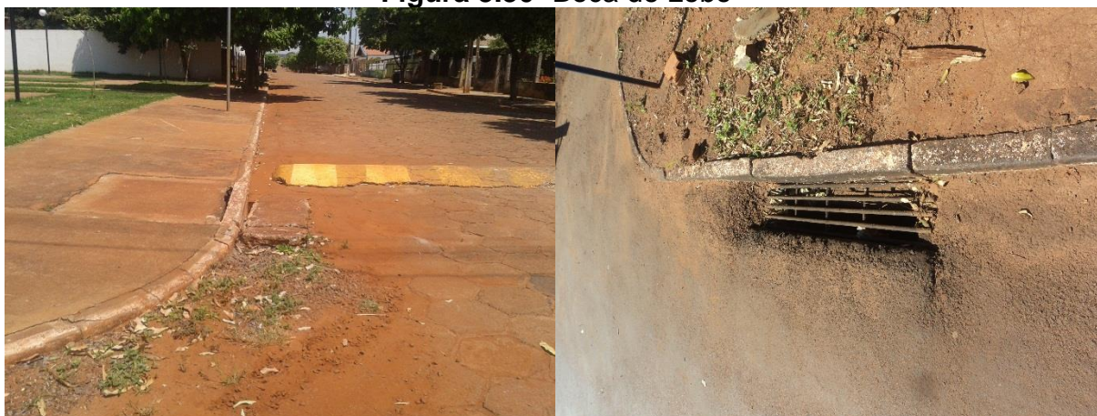
Figura 3.30- Boca de Lobo
